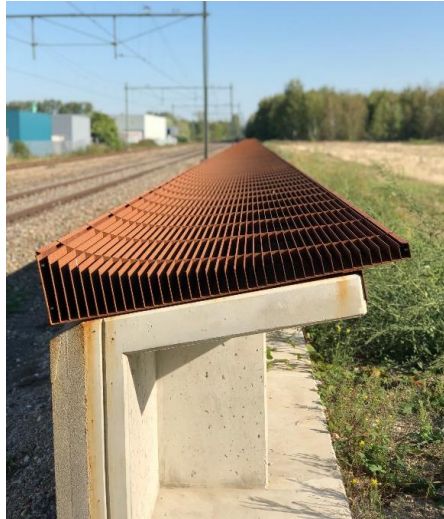
Figuur 14 Diffraactortop op een (laag) geluidscherm in een geluidproef van ProRail bij Susteren.
